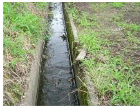
破損したU字溝
