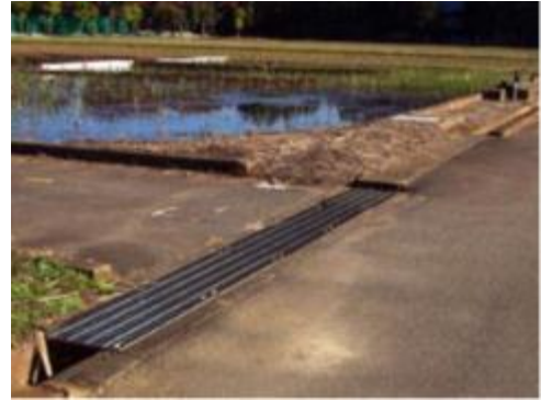
コンクリート蓋とグレーチング
