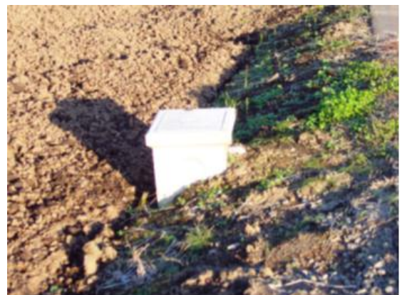
傾いた給水栓ボックス
