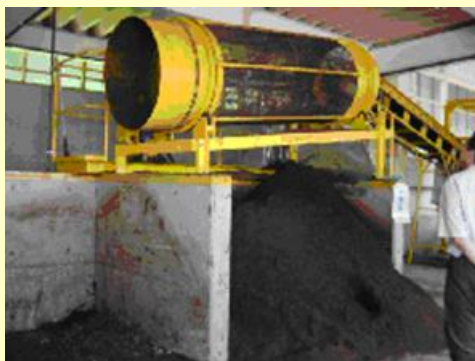
堆肥プラント
