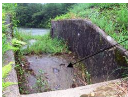
洪水吐底板（コンクリート）の欠損
