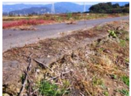
路肩の浸食と路面下の空洞
