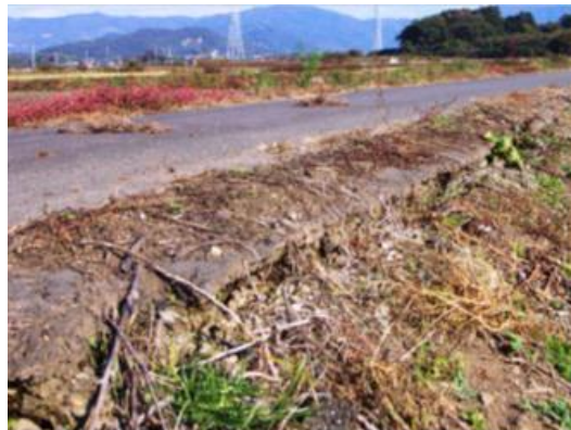
路肩の浸食と路面下の空洞
