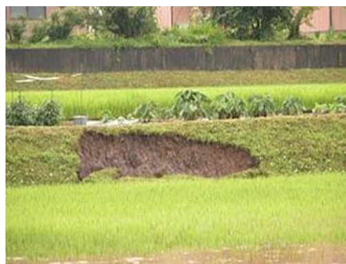
法面の崩壊状況
