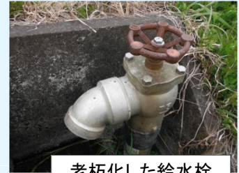
老朽化した給水栓
