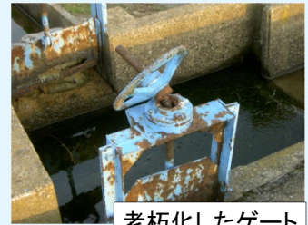
老朽化したゲート
