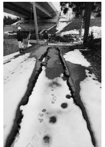
管路埋設下で亀裂・陥没した道路
