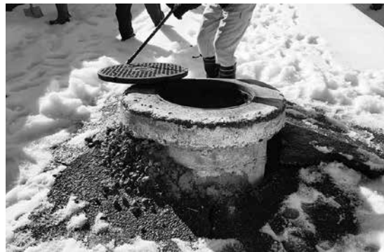
浮き上がったマンホール
