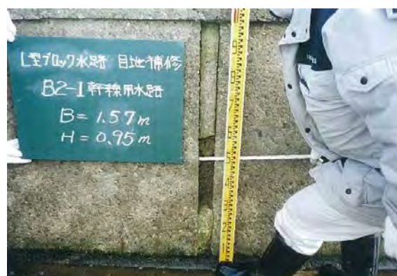
変状の(近景)接写
