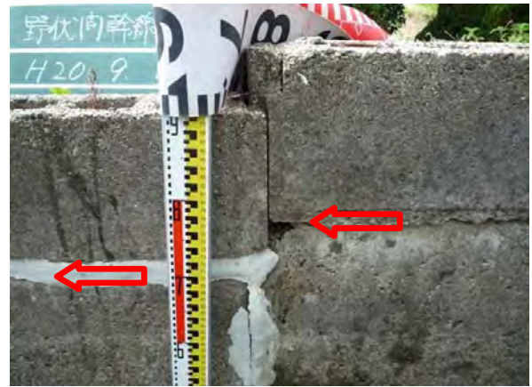
変状の(近景)接写
