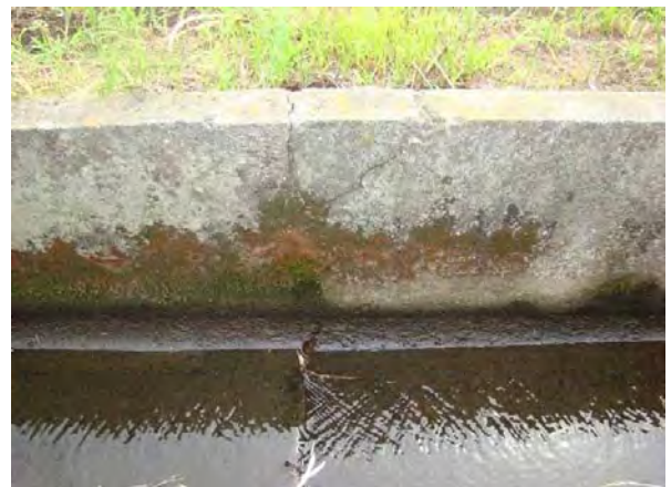
変状の(近景)接写
