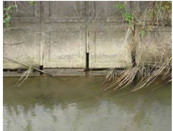
変状の(近景)接写
